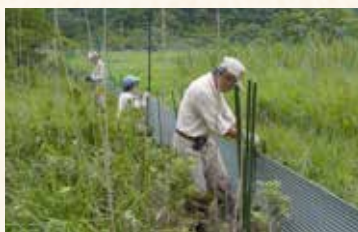
湿原の重要箇所を防獣ネット（シカ用）とトタン（イノシシ用）で囲う。車両が通れる道はなく、資材の運搬はすべて人力による
